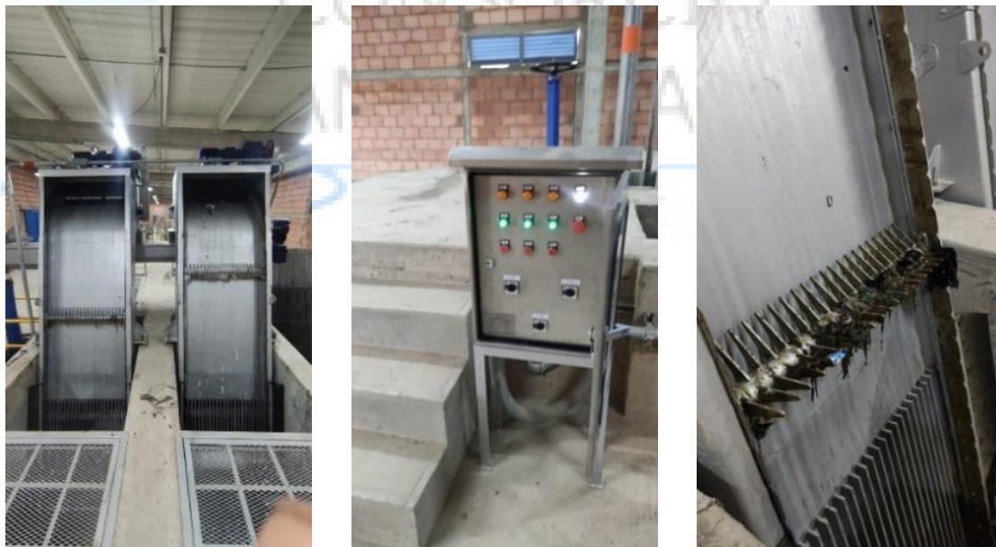
Ilustración 13. Rejas Mecánicas Desarenador
