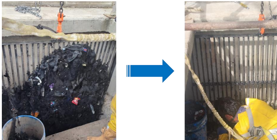
Ilustración 7. Proceso de Limpieza de la Rejilla Deslizante
