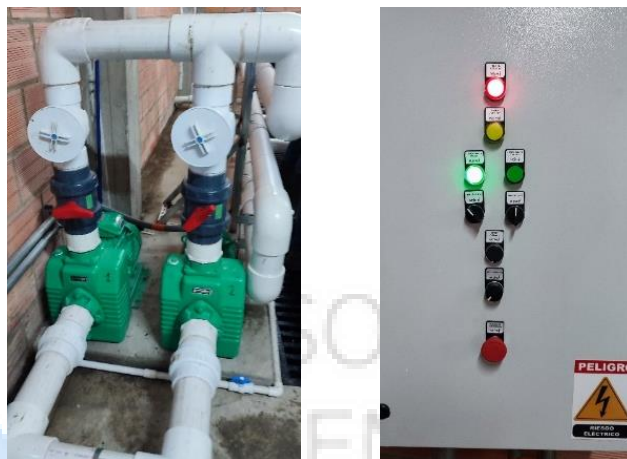
Ilustración 42. Bombas de Lodo Digerido
