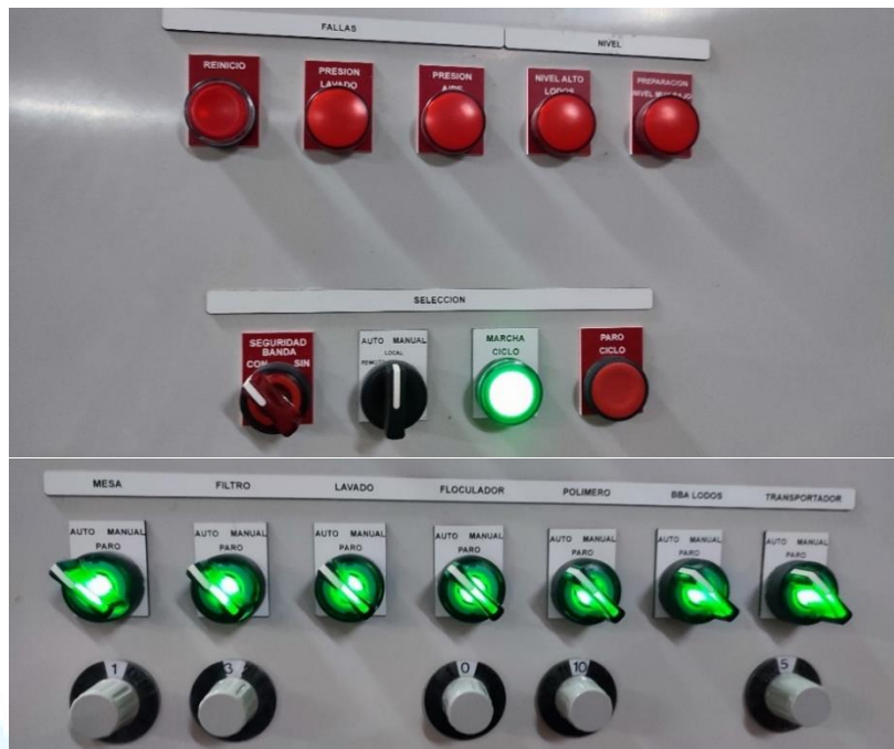
Ilustración 46. Tablero de Operación Equipo EMO (Espesamiento, Deshidratación)
