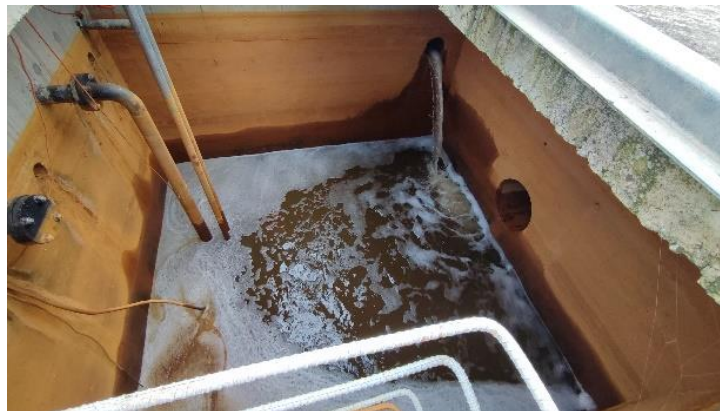
Ilustración 51 Planta Elevadora de Excesos
