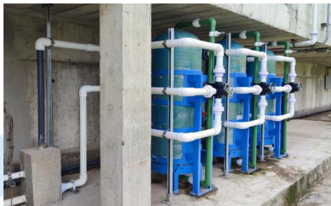
Ilustración 32. Cuerpos Filtrantes de la Planta de Servicio
