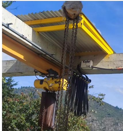
Ilustración 11. Polipasto mecánico para retiro de bombas
