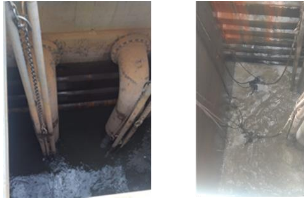
Ilustración 10. Cámara de Bombeo en Operación
